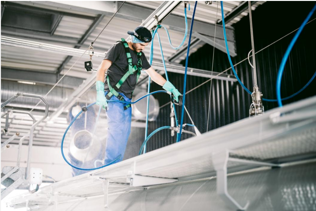
STEP* Station d'Épuration
